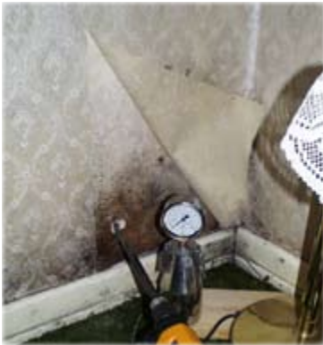
In den Wintermonaten kommt es verstärkt zu Kondensfeuchte mit Schimmelbildung. Hier wirken gleiche physikalische Gesetze. Die Wände sind ungenügend „aufgewärmt“ und die sich bildende Kondensfeuchte „steht“ längere Zeit auf der Wandoberfläche. Die mit dem CM-Messgerät ermittelte Feuchtigkeit im Mauerwerk lag bei 0 %
