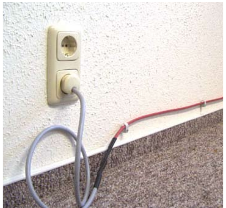
Im Einsatz gegen den Schimmel: Die Sockelheizung der Firma RIWAK wurde auch schon im TV in der Sendung „EINFACH GENIAL“ vorgestellt. Jetzt untersuchte der Sachverständige Dipl.-Ing. Eberhard Ritter vom Ingenieurbüro in Dessau die Wirkungsweise der Sockelleistenheizung und bestätigte ihre Wirksamkeit bei der Bekämpfung von Schimmelbildung im Wohnbereich.
